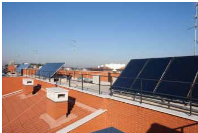
Pannelli solari: intervento AIC nel P.d.Z. di Borghesiana Pantano comparto A/p (Foto Giovanni Ladu)
