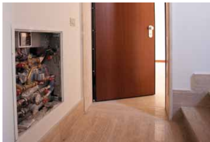
Sistemi di contabilizzazione dei consumi: intervento AIC nel P.d.Z. di Borghesiana Pantano comparto A/p (Foto Giovanni Ladu)
