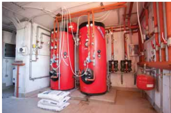
Serbatoi di accumulo di acqua calda sanitaria prodotta dai pannelli solari: intervento AIC nel P.d.Z. di Borghesiana Pantano (Foto G. Ladu)
